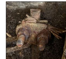
Figura 6: ponto de conexão do aterramento.
