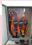
Figura 3 – Disjuntores de alimentação via gerador
