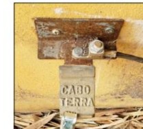
Figura 4: Ponto de equipotencialização para abastecimento
